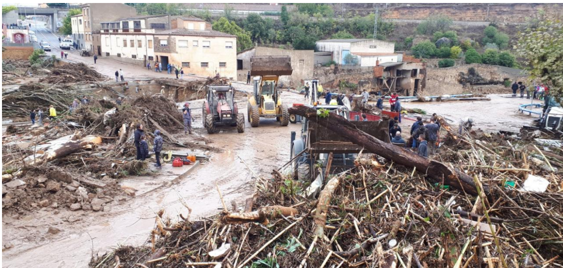
Pont de l'Espluga de Francolí després del temporal de pluja de l'octubre de 2019. Font: Fotografia cedida a la UPC
