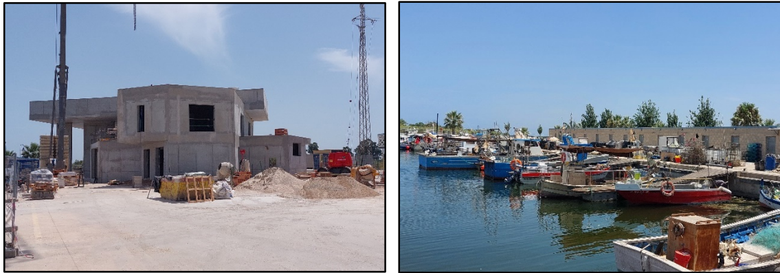
Figura 3.8.- Detall de la construcció de la llotja (esquerra) i la dàrsena pesquera (dreta) del port pesquer de Deltebre.
