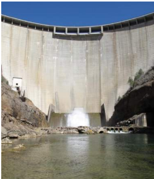
Figura 24. Parament i desguàs de fons de la presa de La Llosa del Cavall, a la capçalera del Cardener
