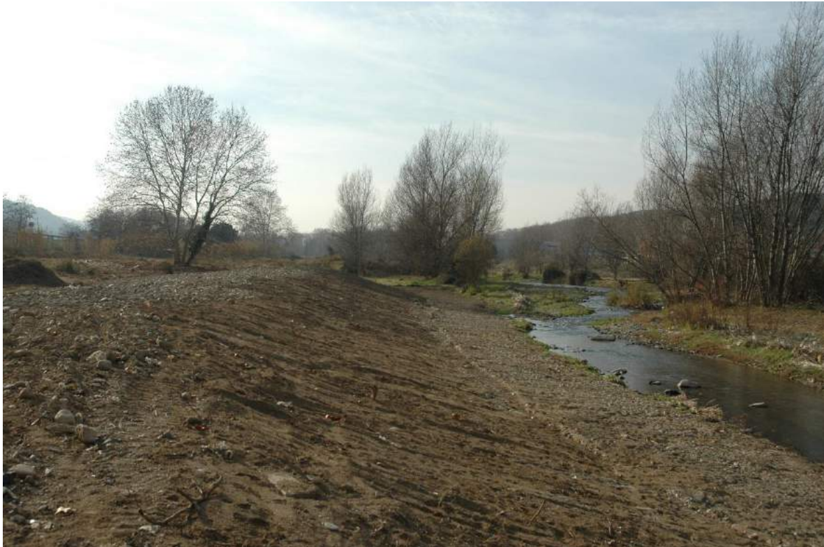
Figura 26. Eliminació d'una mota al riu Llobregat a Sallent, en que es connecta la ribera al canal principal del riu
